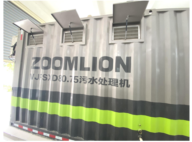
6) 现有生活垃圾渗滤液处理装置
